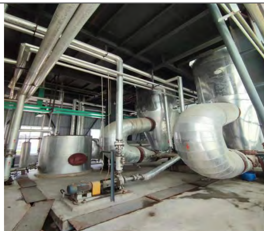
MVR 蒸发脱盐
