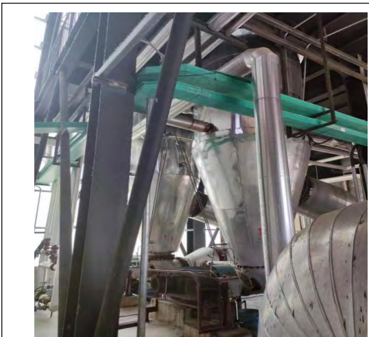
MVR 蒸发脱盐
